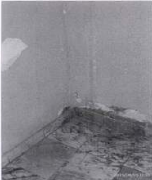
Foto 07 resquebrajamiento de pintura
