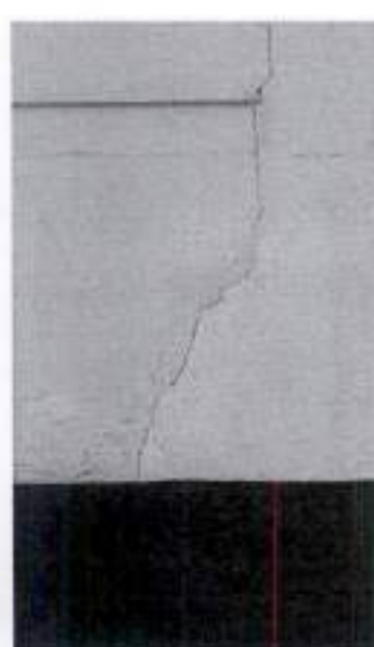
Foto 06 rajadura del muro
