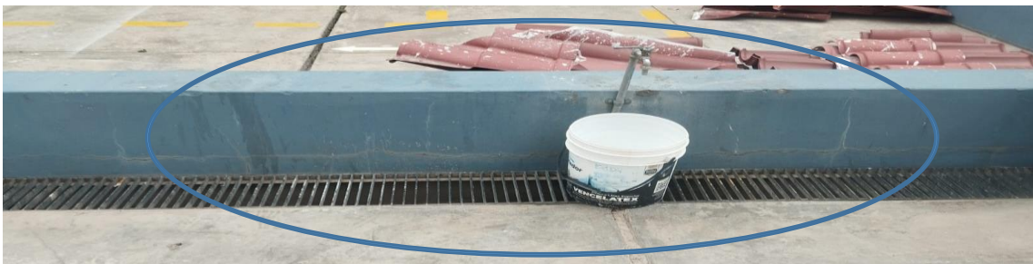
FACHADA DE LO MUROS Y ESTERIORES DEL LA COCHERA DE LA SEDE, EXISTIENDO DESGASTE, EROSION DE LA PINTURA ACTUAL Y POR ENDE EXPOSICION A LA HUMEDAD EN TEMPORADA DE LLUVIAS
