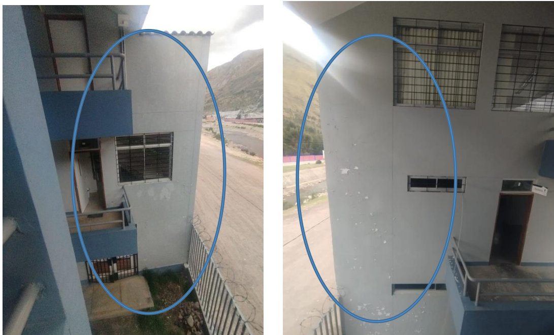
FACHADA DE LA PARTE POSTERIOR DE LA SEDE INSTITUCIONAL, EXISTIENDO DESGASTE, EROSION DE LA PINTURA ACTUAL Y POR ENDE EXPOSICION A LA HUMEDAD EN TEMPORADA DE LLUVIAS
