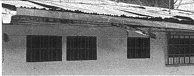
Desprendimiento parcial del falso cielo raso del alero.
