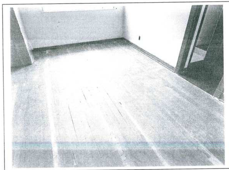
IMAGEN . PISO DETERIORADO EXISTENTES DE MADERA EN SEGUNDO NIVEL.
