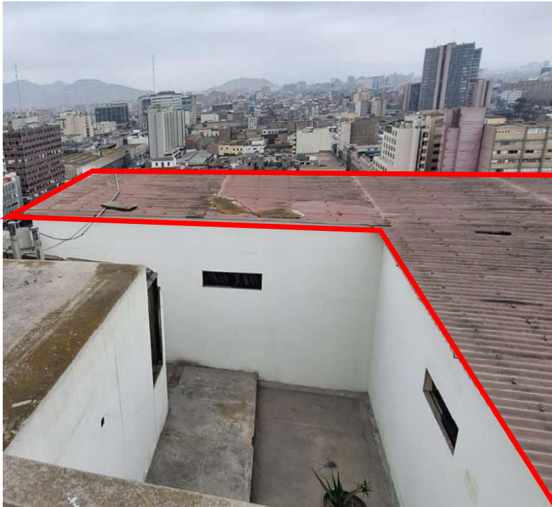
Imagen N°01: En la imagen se muestra la cobertura que deberá ser repuesta. El área de la cobertura a retirar es de 92.55 m 2 ; así mismo se deberá de instalar 115.10 m 2 de cobertura de Aluzinc tr4, la cual deberá de instalarse asegurando que se genere el alero de 0.50 m en los bordes.
