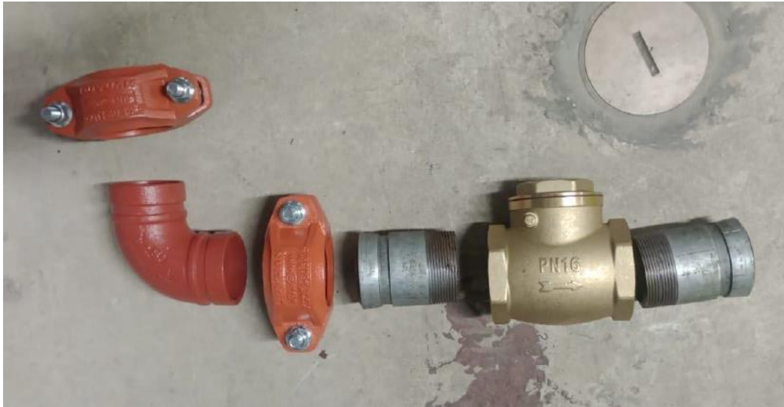
Figura 02: Detalle de componentes de tubería de descarga por reemplazar
