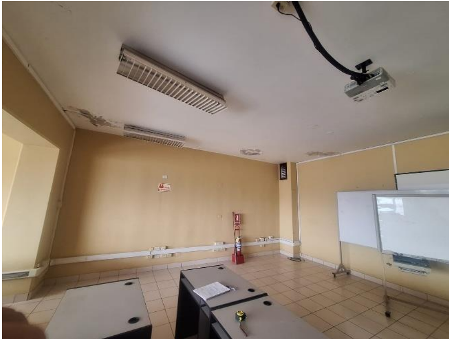
Imagen N°01: Se muestra que la parte interior del techo, se muestra con presencia de humedad y la pintura muestra desprendimientos. Se ha planteado la ejecución de la partida de picado del tarrajeo existente y su reposición en 14.26 m 2 .
