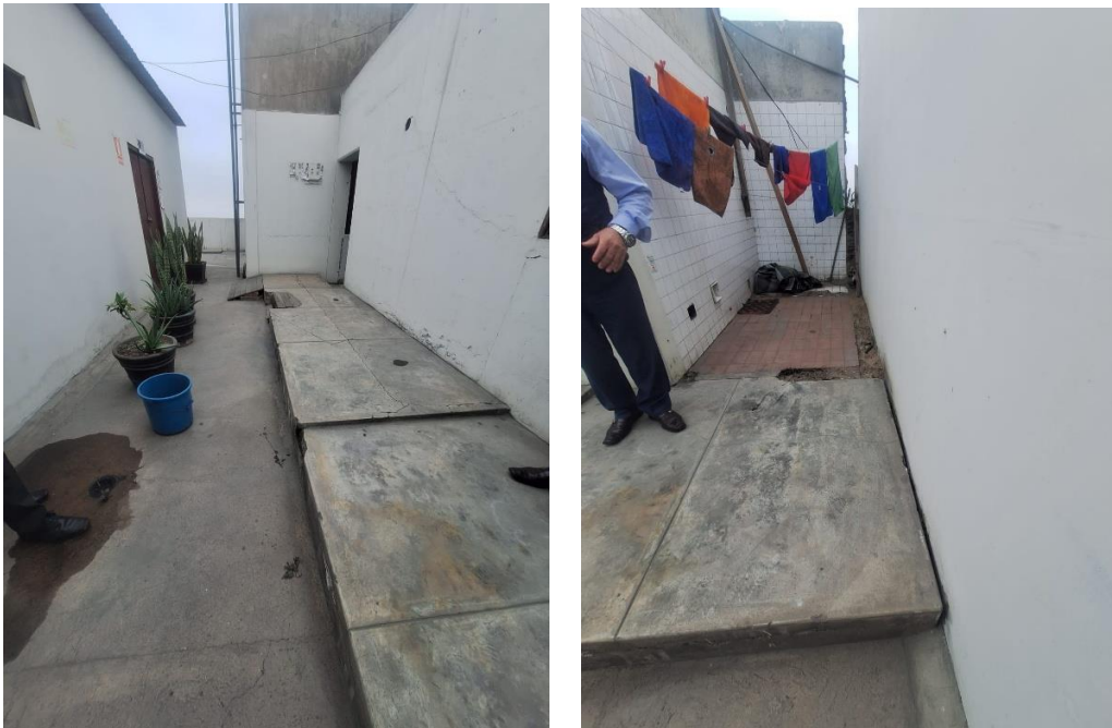
Imagen N°04: Se muestra que la parte superior del techo, se muestra que es necesario realizar el picado y resane del piso de concreto. La partida de picado y resane de piso de concreto se realizará en 30.51 m 2 . Posteriormente, se deberá de realizar la partida de membrana líquida impermeabilizante sobre el área que se realizará el resane.
