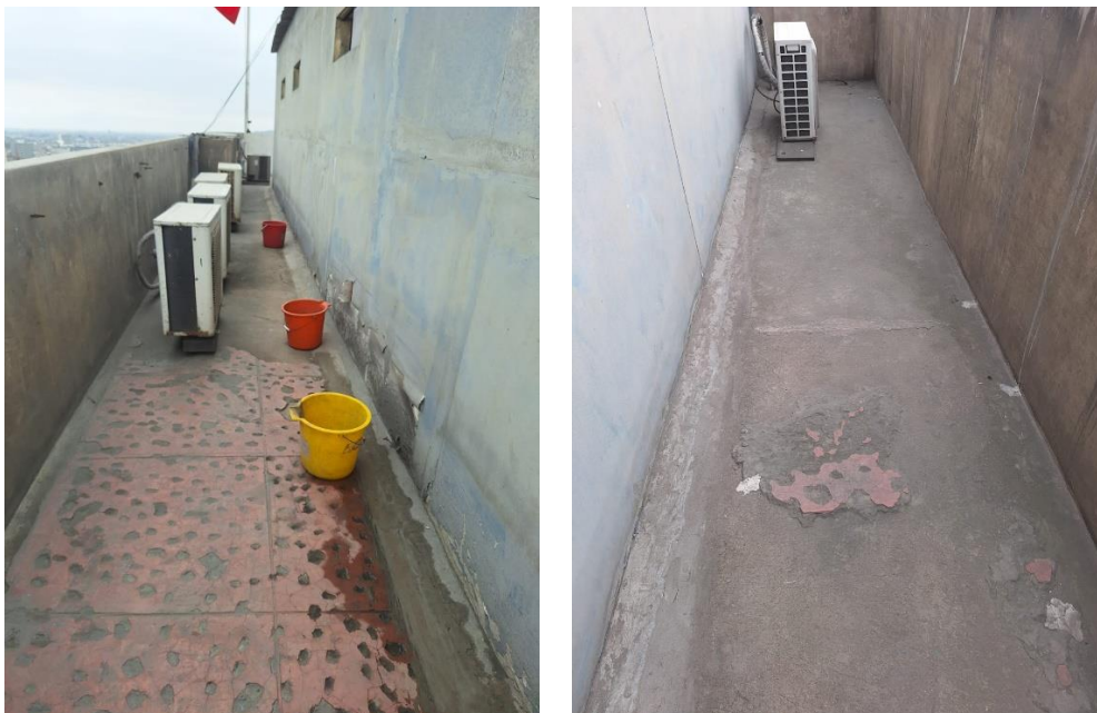
Imagen N°02: Se muestra que la parte superior del techo, se muestra que es necesario realizar el picado y resane del piso de concreto. Se deberá de realizar el retirado del material cerámico, y se deberá de dejar el piso en situación óptima para recibir la impermeabilización. La partida de picado y resane de piso de concreto se realizará en 30.51 m 2 .
