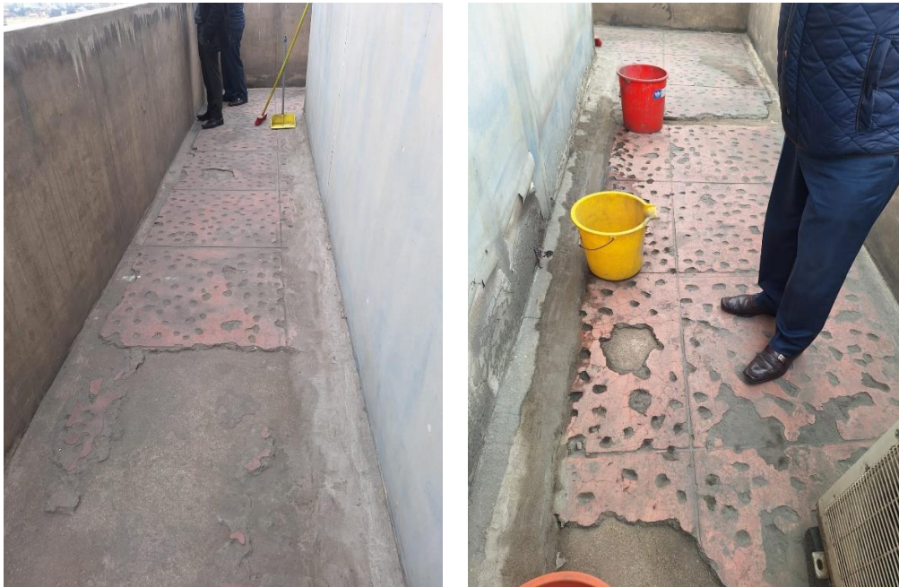
Imagen N°03: Se muestra que la parte superior del techo, se muestra que es necesario realizar el picado y resane del piso de concreto. Se deberá de realizar el retiro del material cerámico, y se deberá de dejar el piso en situación óptima para recibir la impermeabilización. La partida de picado y resane de piso de concreto se realizará en 30.51 m 2 .
