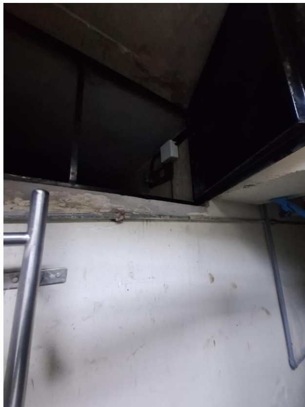
En la imagen se muestra la ubicación de la cisterna de agua, en donde se realizara el cambio del sensor de nivel de agua, ubicado en el tanque elevado y en la cisterna de agua.
