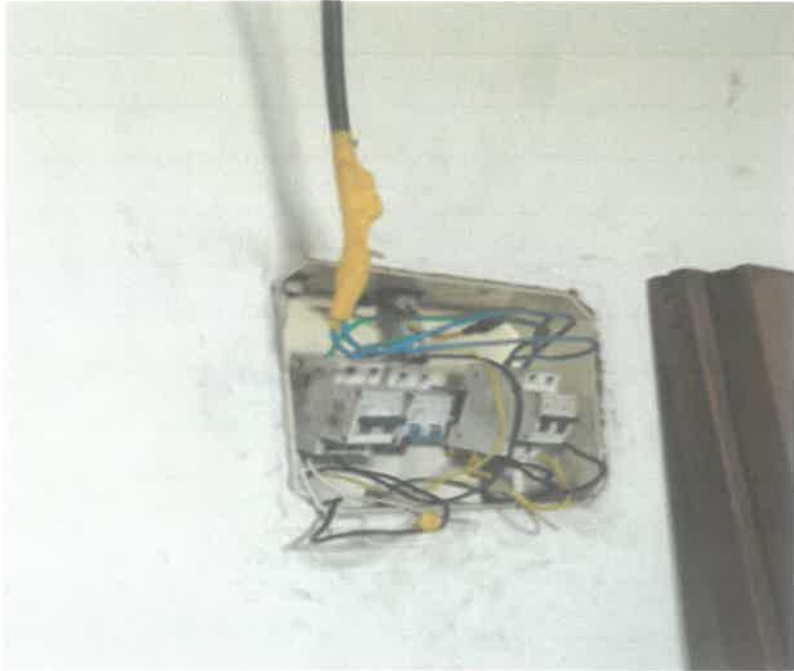
Fig. 5. Tablero eléctrico en pésimas condiciones
