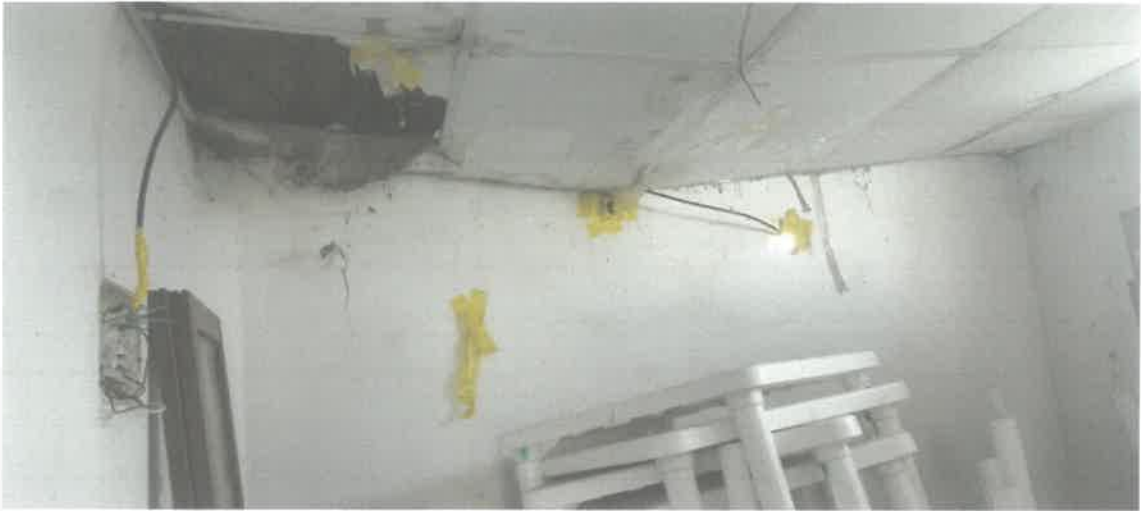
Fig. 3 Cielorraso en pésimas condiciones
