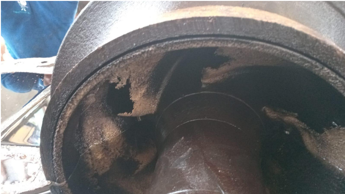
Alabes del impulsor presenta desgastes de consideración producto de la cavitación
