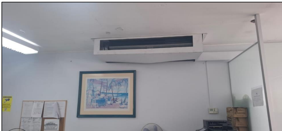
Ilustración 2. DPTO DE RECUPERACIONES - REEMPLAZO DE EQUIPO
