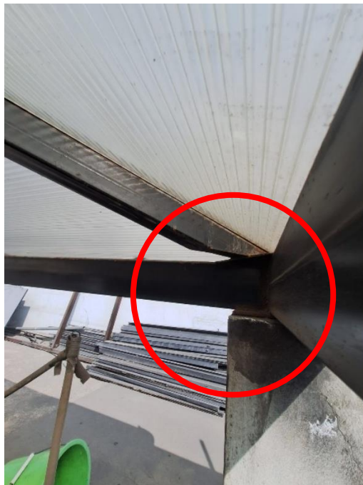
Imagen N°12: En la imagen se observa la estructura de cúpula ubicada en el tragaluz de la torre B. Asimismo, se evidencia que algunas partes de la estructura presentan corrosión superficial, por lo cual es necesario realizar los procedimientos correspondientes de acuerdo con la especificación técnica.
