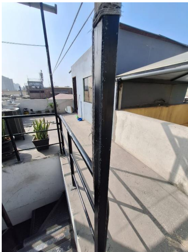
Imagen N°15: En la imagen se observa la estructura de la escalera tipo L. Se evidencia corrosión en las barandas y en la estructura de cobertura, por lo que es necesario ejecutar los procedimientos definidos en la especificación técnica correspondiente a la partida.
