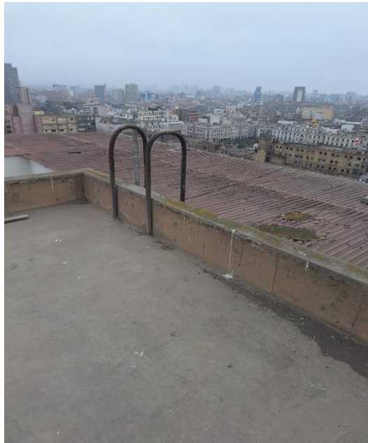
Imagen N°09: En la imagen se observa la escalera metálica tipo gato, con una altura de H = 4.70 m , la cual recibirá mantenimiento. Se deberán sustituir las partes afectadas por corrosión, ejecutar los procedimientos detallados en la especificación técnica , y aplicar un anticorrosivo seguido del acabado final .
