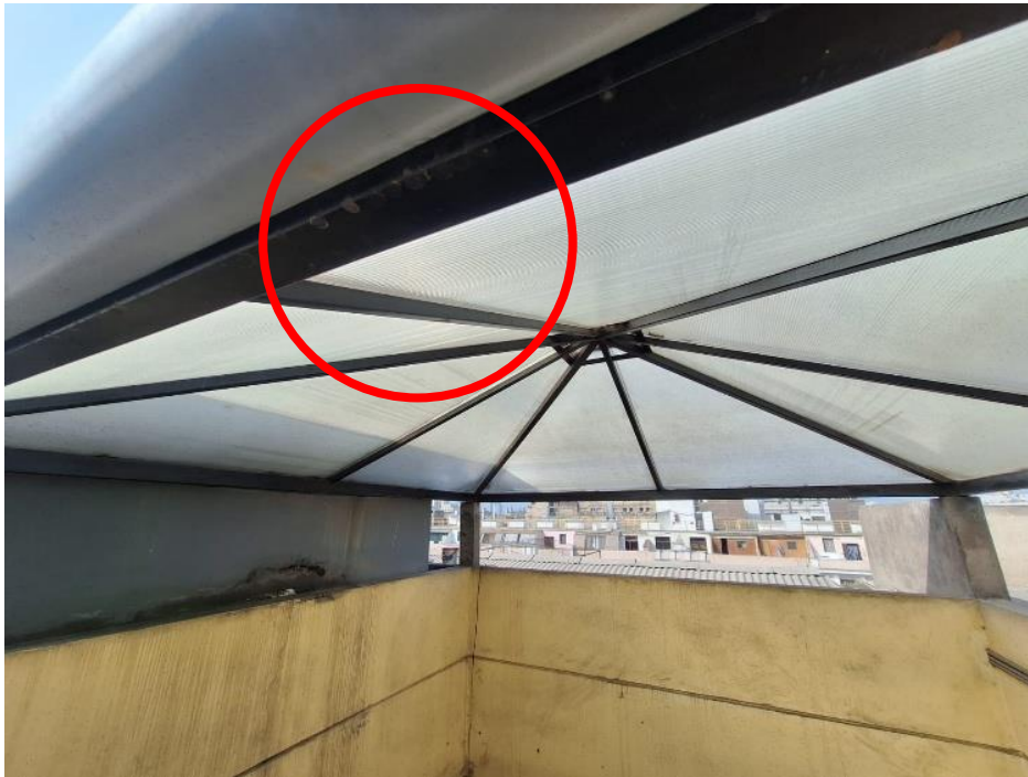
Imagen N°13: En la imagen se observa la estructura de cúpula ubicada en el tragaluz de la torre B. Asimismo, se evidencia que algunas partes de la estructura presentan corrosión superficial, por lo cual es necesario realizar los procedimientos correspondientes de acuerdo con la especificación técnica.
