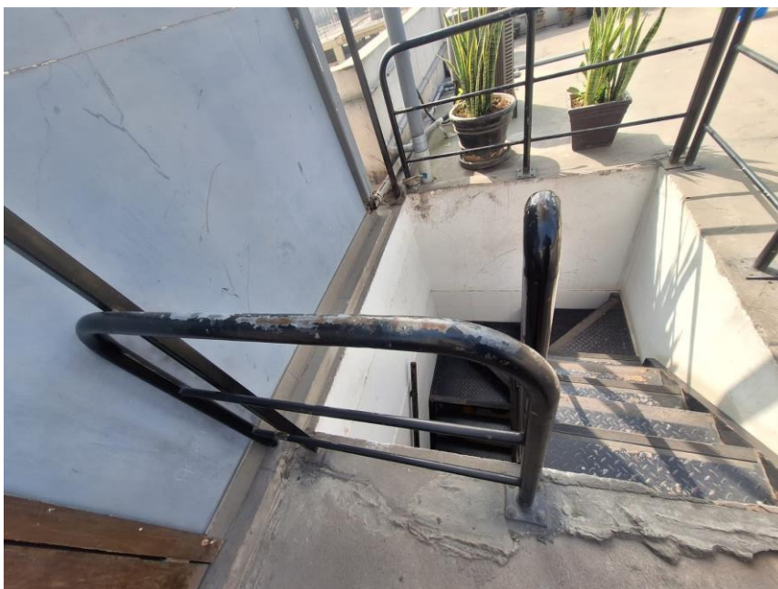
Imagen N°16: En la imagen se observa la estructura de la escalera tipo L. Se evidencia corrosión en los pasos y contrapasos, por lo que será necesario realizar el mantenimiento y se deberá de realizar la instalación de guardacantos reflectivos .
