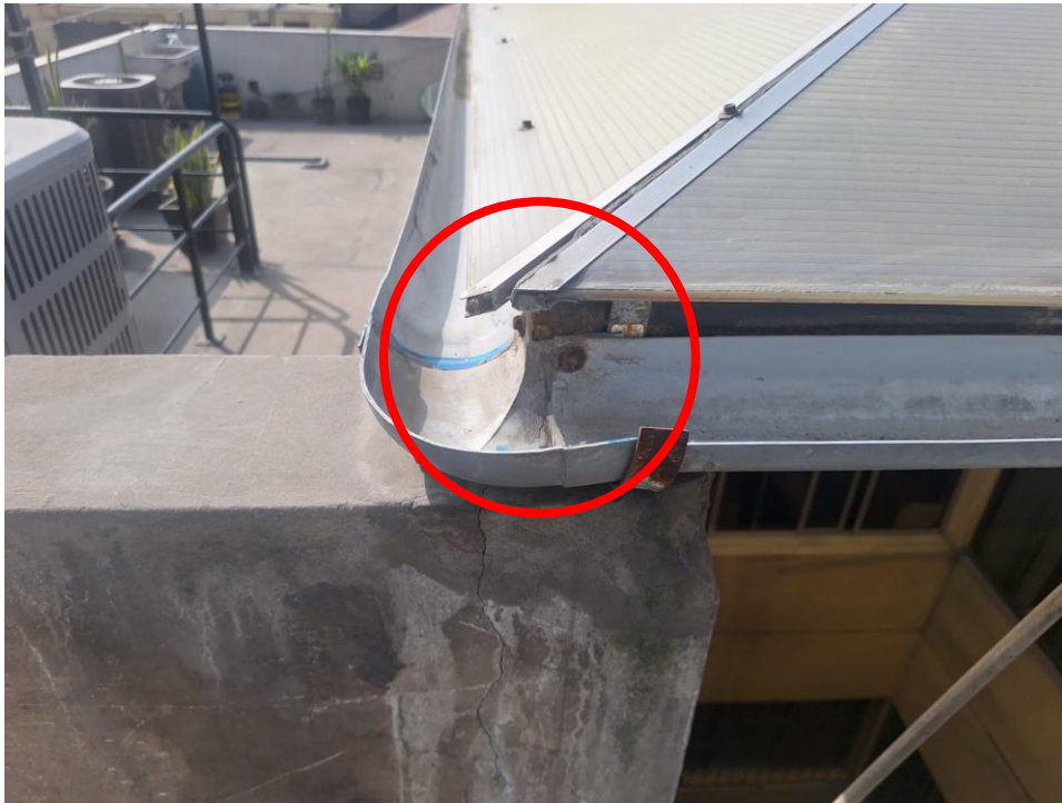
Imagen N°11: En la imagen se observa la estructura de cúpula ubicada en el tragaluz de la torre B. En el perímetro de la estructura se encuentra adosada una canaleta, la cual está sujeta mediante pernos que deberán ser reemplazados con el fin de prolongar la vida útil de la instalación. En esta área se ejecutará la instalación de barandas de 0.53 m de altura, fabricadas en acero inoxidable .
