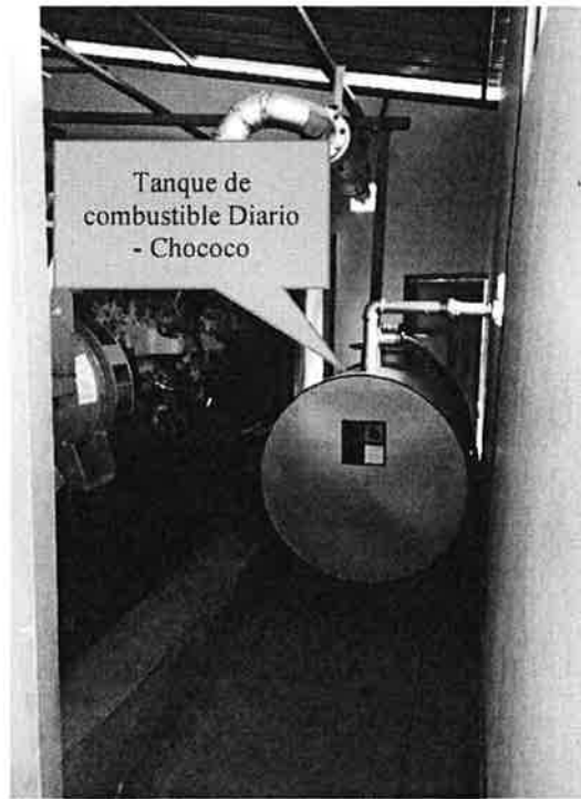
Tanque de combustible Diario – Chococo
