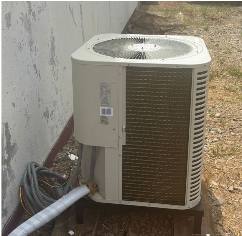
IMAGEN 04: Condensador de equipo de aire acondicionado
