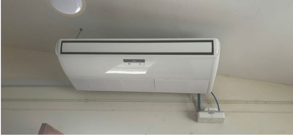
IMAGEN 03: Evaporador de Equipo Aire Acondicionado
