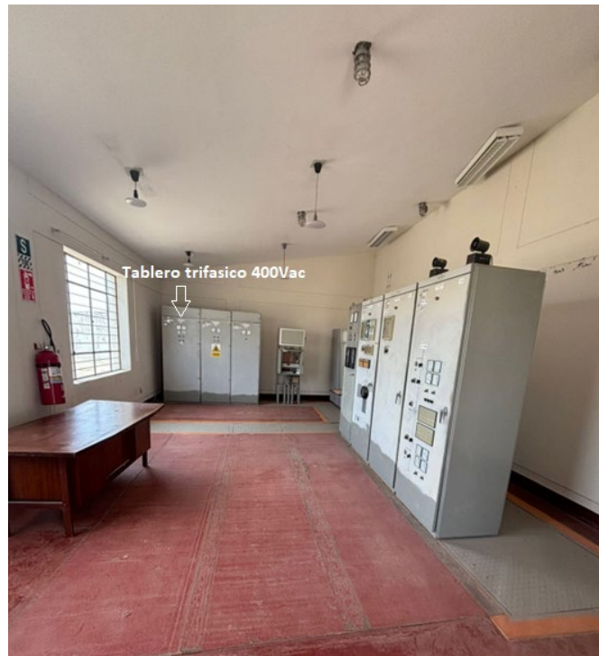
IMAGEN 01: Sala de Control de la Subestación
