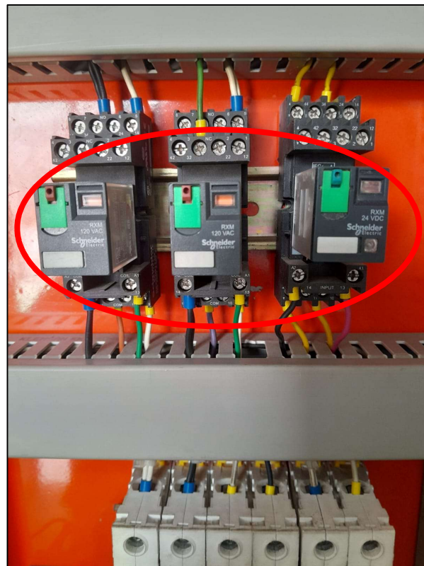
Mini relés de Tablero Eléctrico
