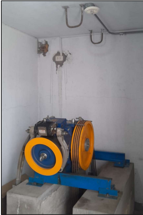
Motor de ascensor
