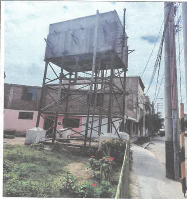
Figura N°01: Se observa el deterioro del reservorio de estructura metálica lo cual esta correidos dicha estructura que resiste el peso del reservorio elevado
