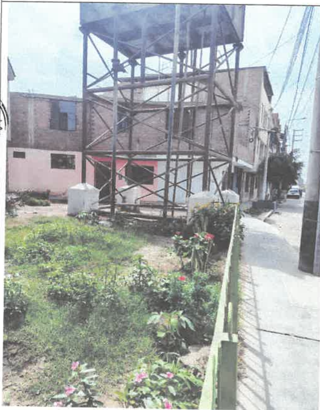
Figura N°02: Se observa el deterioro del reservorio de estructura metálica lo cual presenta deterioro de los dados de concreto que soporta el reservorio elevado
