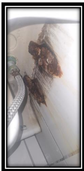
Ilustración 2: Válvula de ingreso a inodoro
