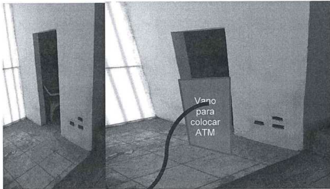
Imagen 6 y 7 : Imagen de vano, que se debera cerrar con concreto armado para colocar el ATM.
