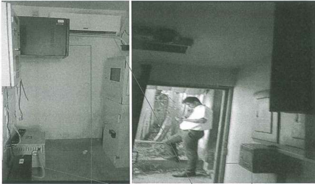
Imagen 3 y 4 Rack de comunicaciones, UPS , aire acondicionado y puerta a desmontar del lobby del Hospital Regional de Ucayali
