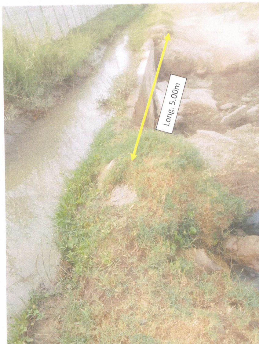
Imagen 01.- Se visualiza muro a reconstruir de 1.00m de profundidad y 5.00 m de largo.
