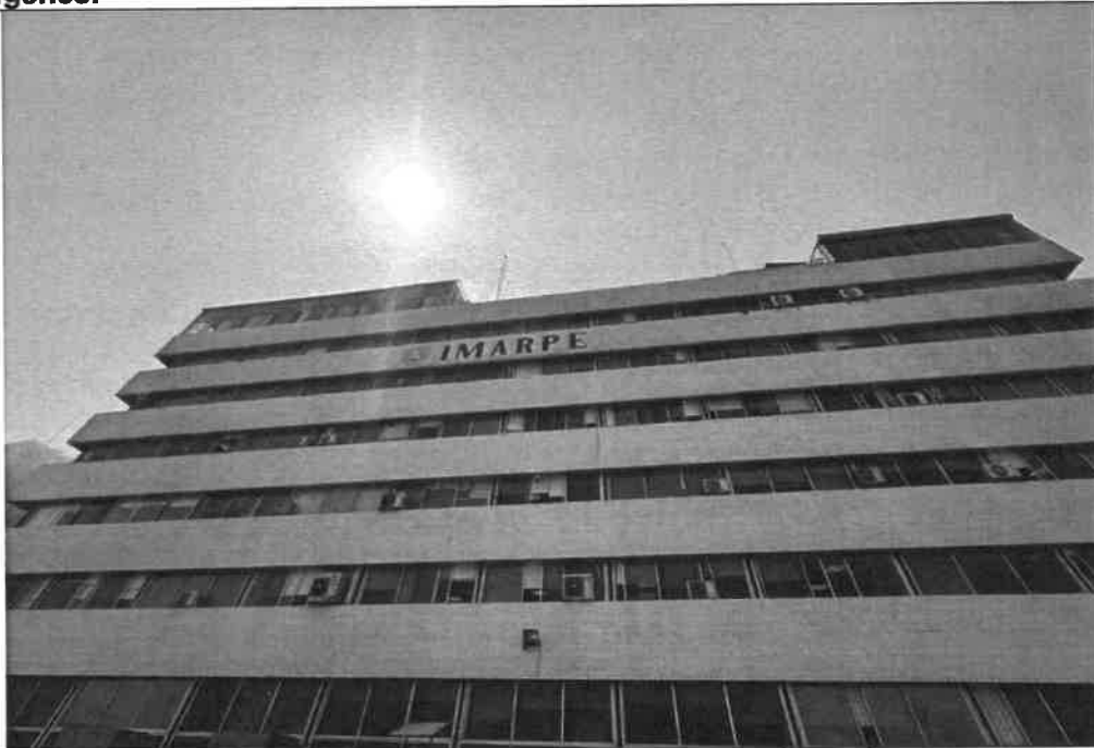
Imagen 1: Estado actual del muro (superficie al cual se le debe realizar el mantenimiento, y preparar la superficie) Fachada posterior del Instituto del Mar del Perú – IMARPE Sede Central.
