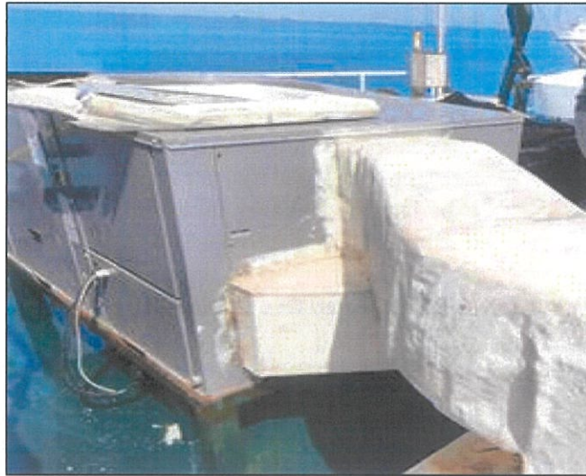
Imagen del equipo de aire acondicionado.
