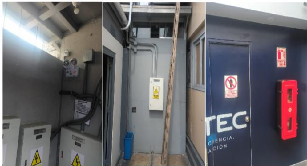
Imagen Cuarto de tableros
