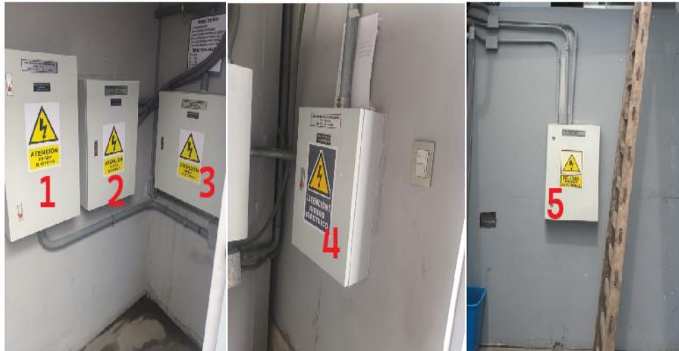
Imagen Tableros eléctricos a desmontar
