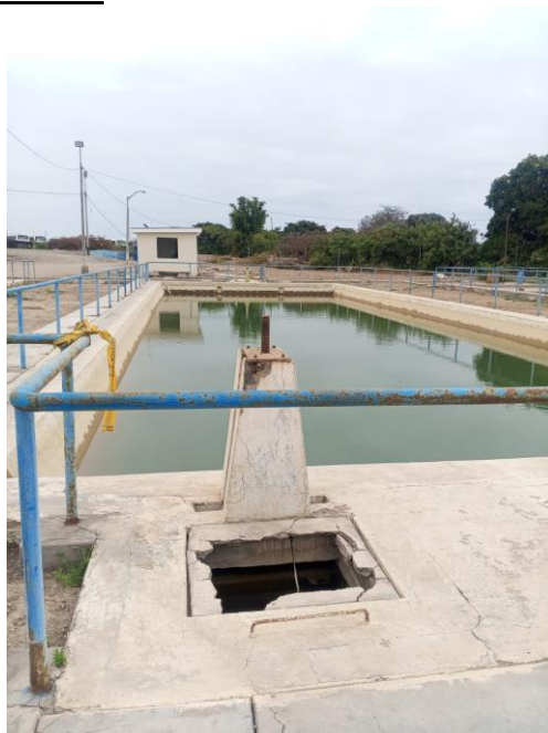
Foto 01. Tapa de buzón deteriorado a salida de presedimentador 02
