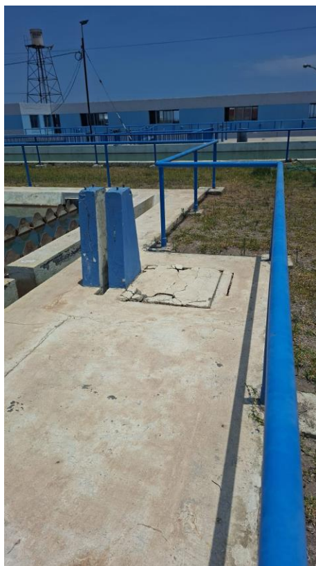
Foto 02. Tapa de buzón deteriorado a salida de sedimentador 02
