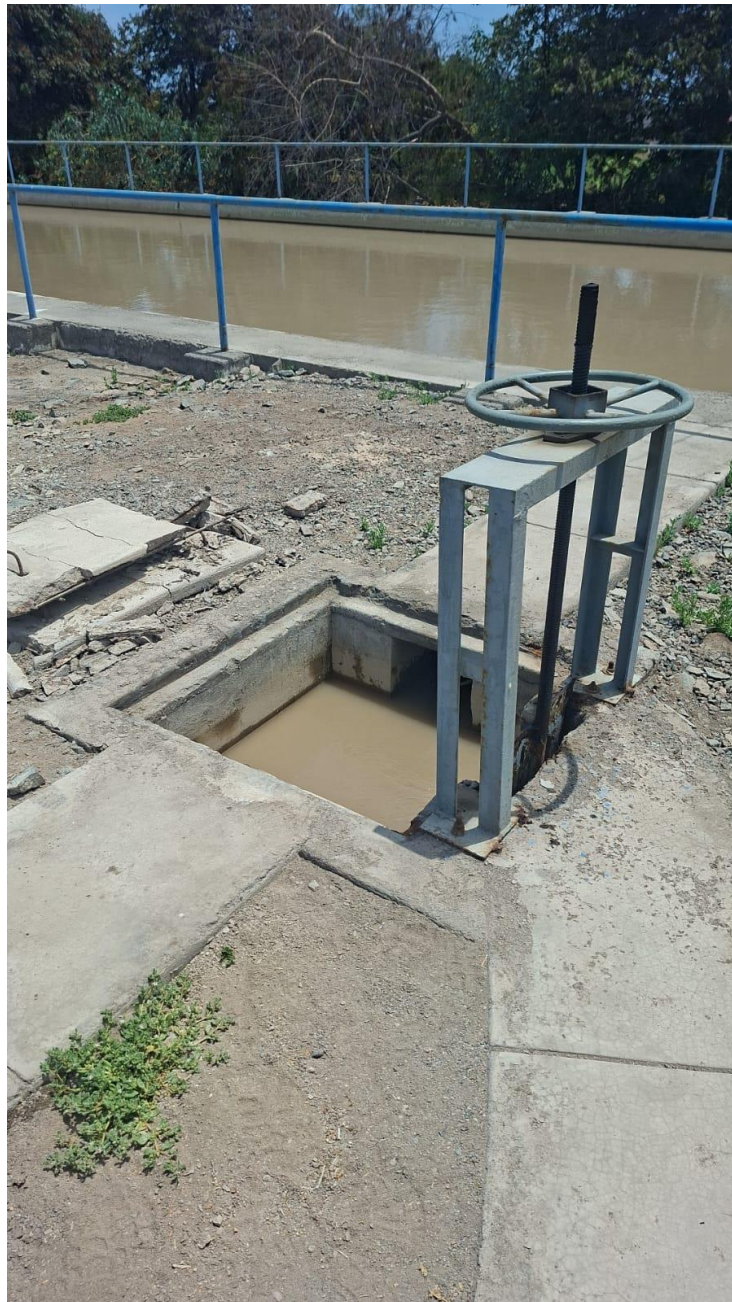
Foto 03. Tapa de buzón deteriorado a salida de Presedimentador 03
