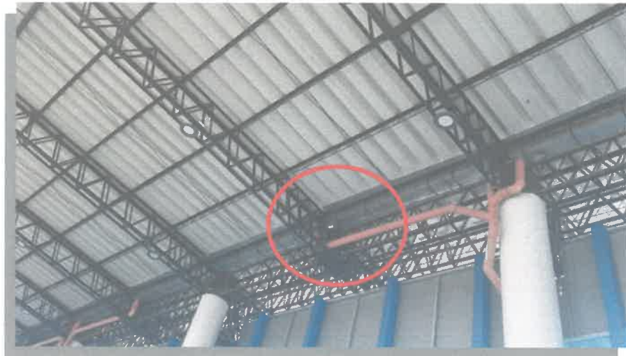
Presencia de vacíos en juntas de las canaletas con la cobertura
