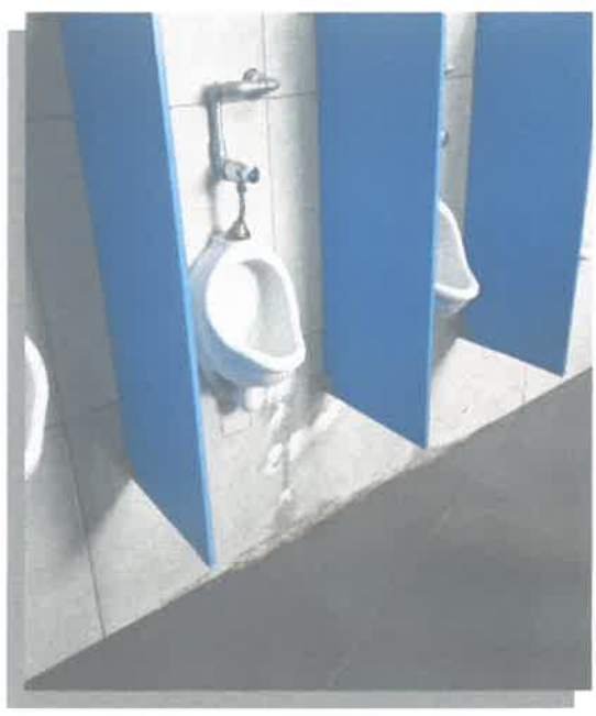
Filtraciones sistema de desagüe
