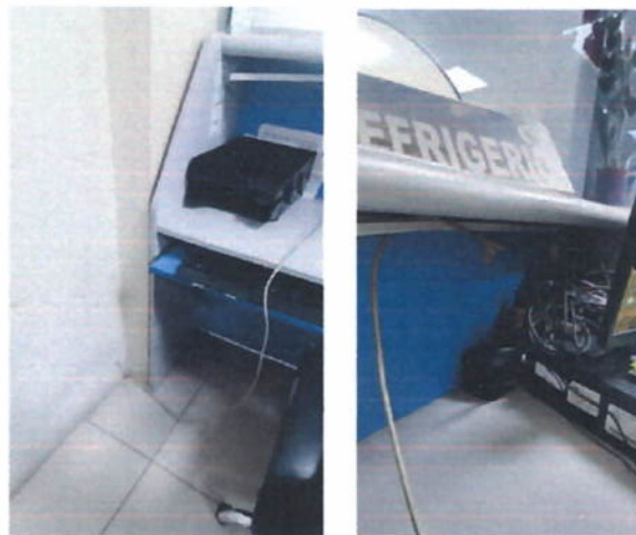
IMAGEN: CABLEADO EXISTENTE
