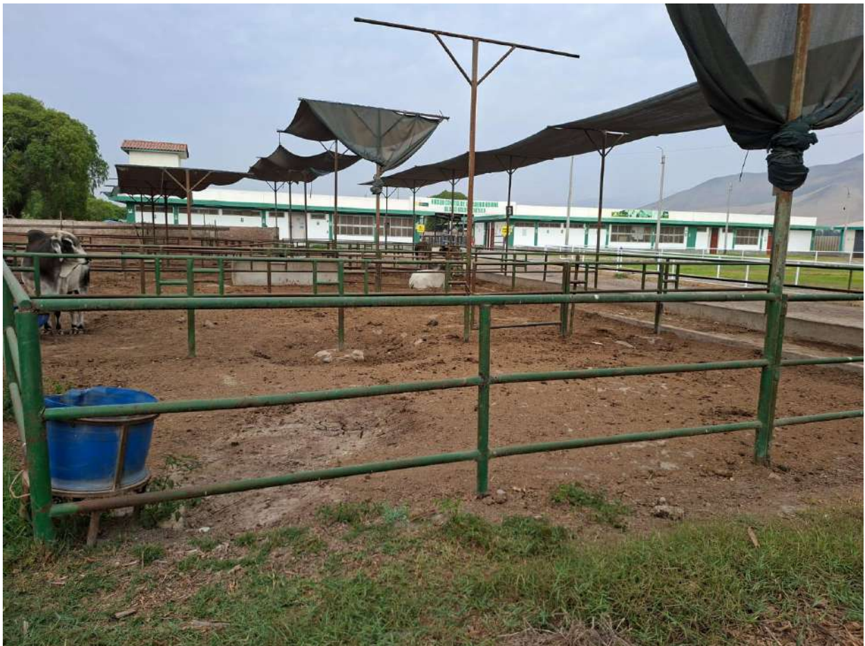
Se aprecia las estructuras sin mantenimiento respectivo, la malla raschel se aprecia en condiciones de deterioro
