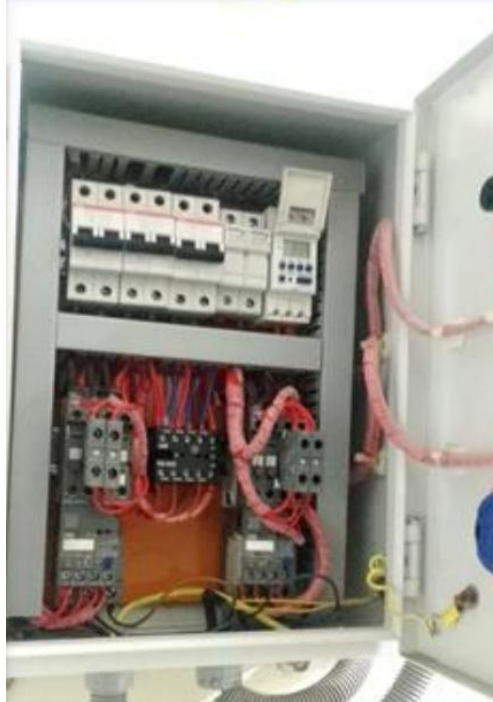
Foto 01: tablero de control existente
