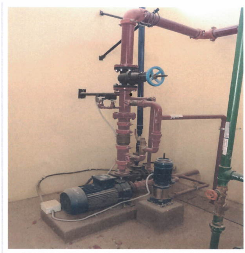
Sistema de Bombeo de Agua Contra incendio
