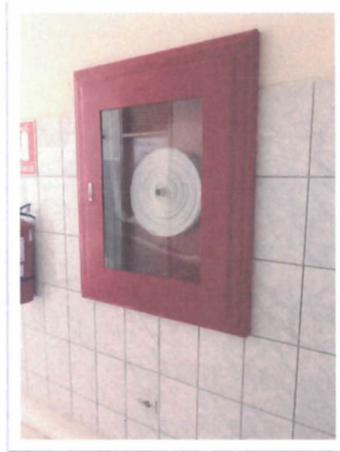
Gabinete Contra incendio
