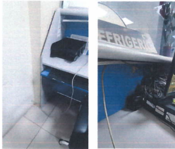
IMAGEN: CABLEADO EXISTENTE
