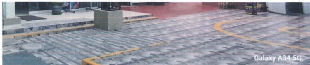
IMAGEN: PISO ENCONTRADO EN PATIO
