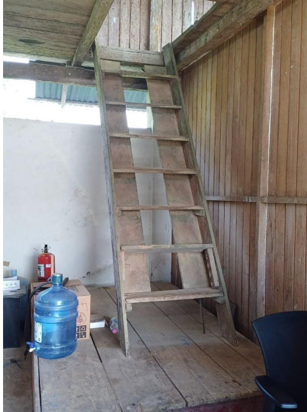
Foto 01: Se aprecia imagen de escalera a remover, así como piso de base.
