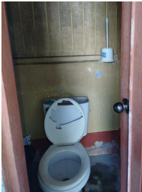
Foto 08: Inodoro a ser remplazado.
