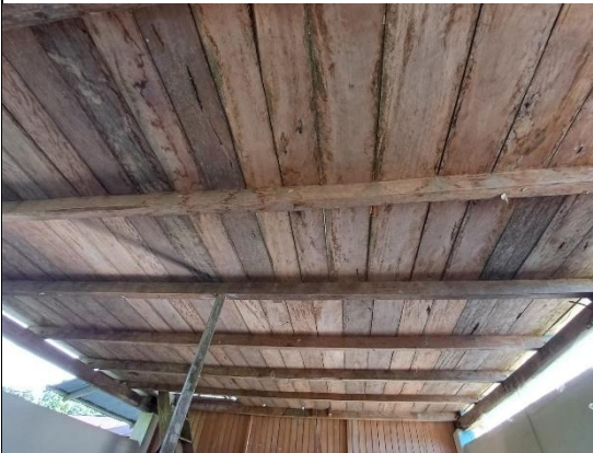
Foto 4-5-6: Se aprecia elementos de madera a intervenir.
