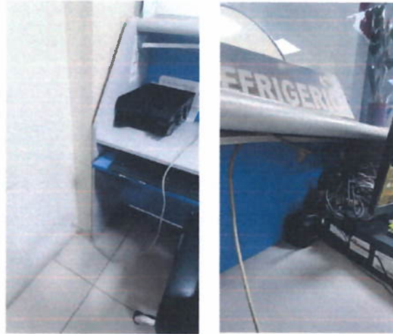
IMAGEN: CABLEADO EXISTENTE
