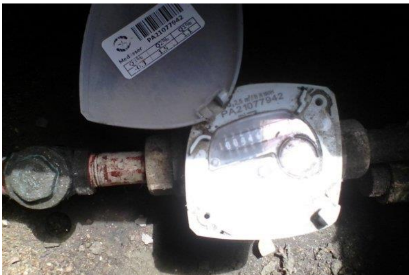
FOTO 03: TOMA INTERNA DE CONEXIÓN AGUA POTABLE
