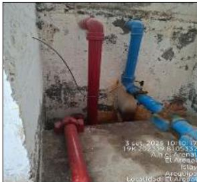
Foto N°5 Presencia de óxido en árbol hidráulico.
