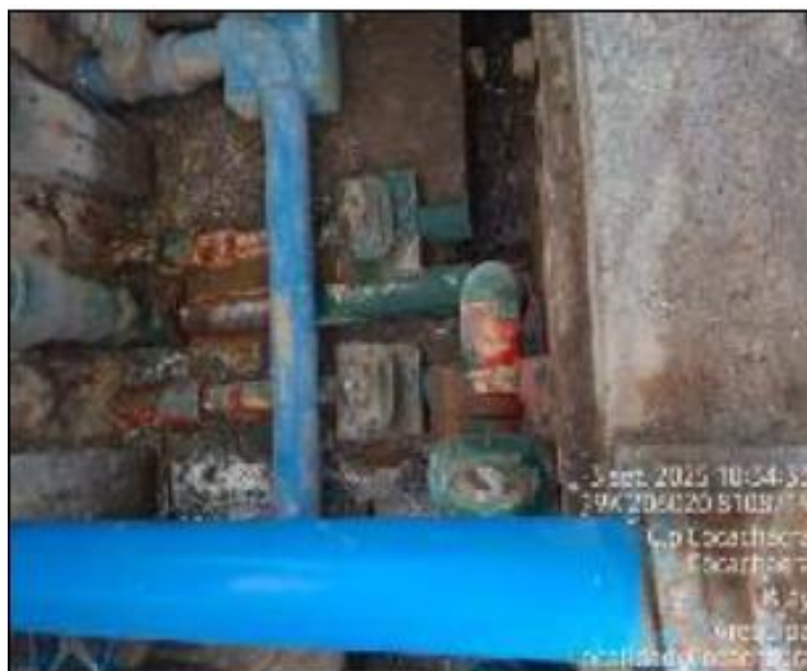
Foto N°6 Presencia de óxido en tubería de ingreso y salida R-1
