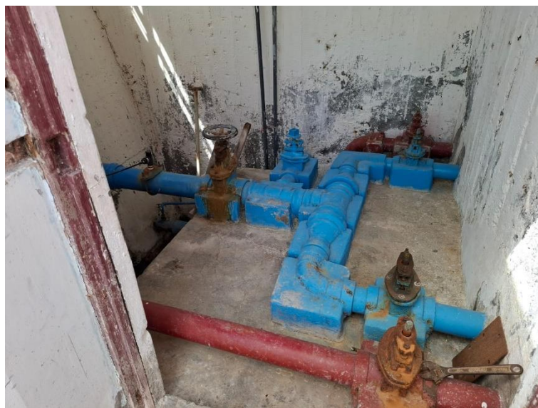
Foto N°2 Presencia de óxido en árbol hidráulico.
