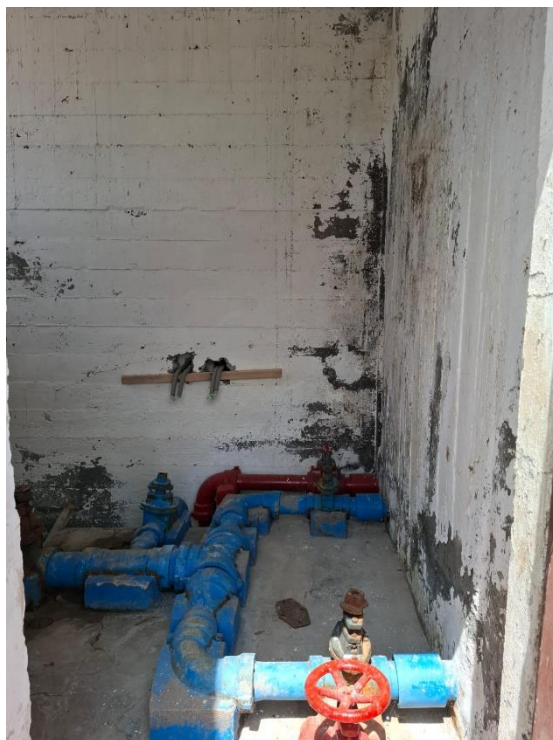
Foto N°4 Presencia de óxido en árbol hidráulico.
