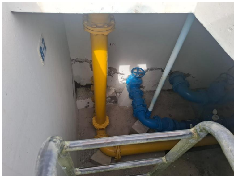
Foto N°1 Presencia de óxido en los volantes de manipuleo.
