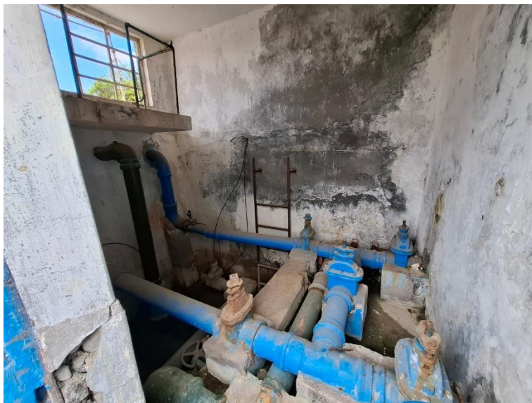
Foto N°7 Presencia de óxido en los volantes de manipuleo del R-1
