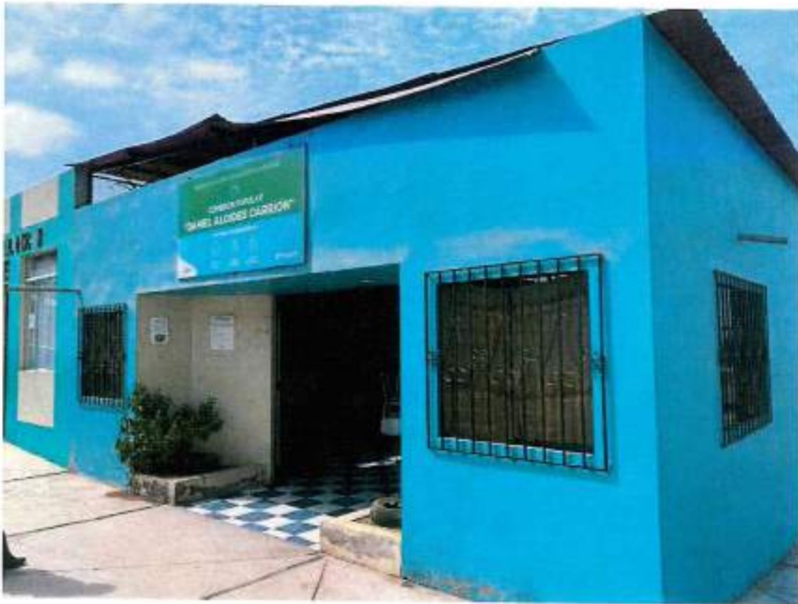
REACONDICIONAMIENTO DE PINTADO EN EXTERIORES E INTREIORES DE COMEDOR POPULAR DANIEL ALCIDES CARRIÓN
