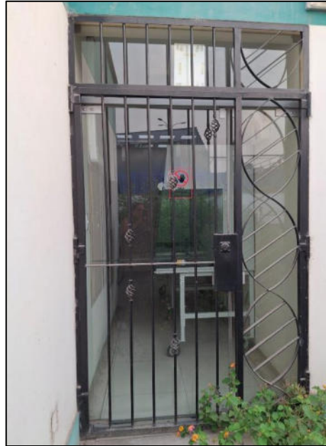
Ilustración 1 Puerta de salida de emergencia actual del laboratorio de Biología Molecular y Genómica
