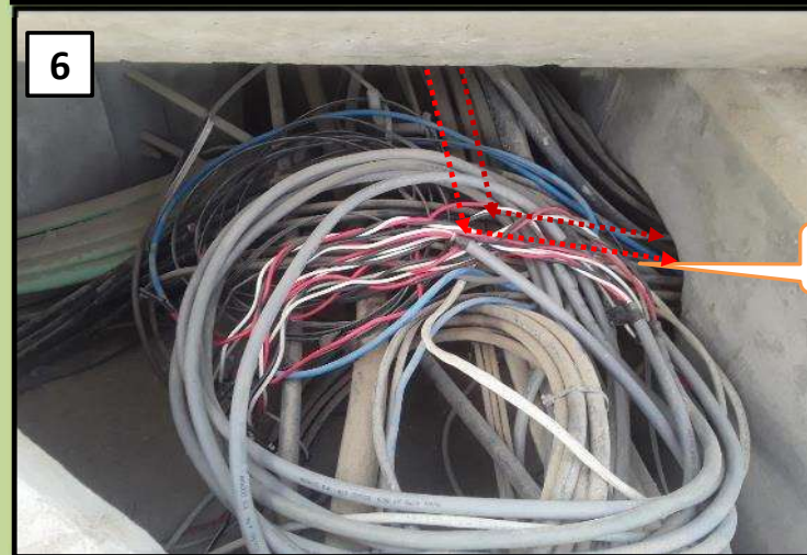
Foto de ingreso de tubería y sale por dentro del shelter de EGESUR.
