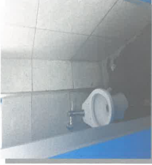
Filtraciones en sistema de agua
