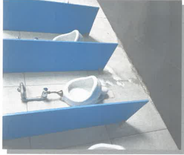
Filtraciones sistema de desague
