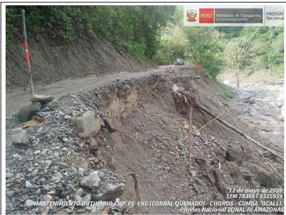
EROSION/SOCAVACION DE PLATAFORMA EN LA PROGRESIVA KM 79+100 AL KM 79+145, SECTOR SAN ISIDRO
