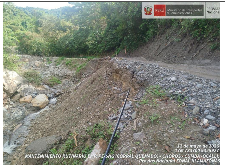
EROSION/SOCAVACION DE PLATAFORMA EN LA PROGRESIVA KM 79+100 AL KM 79+145, SECTOR SAN ISIDRO
