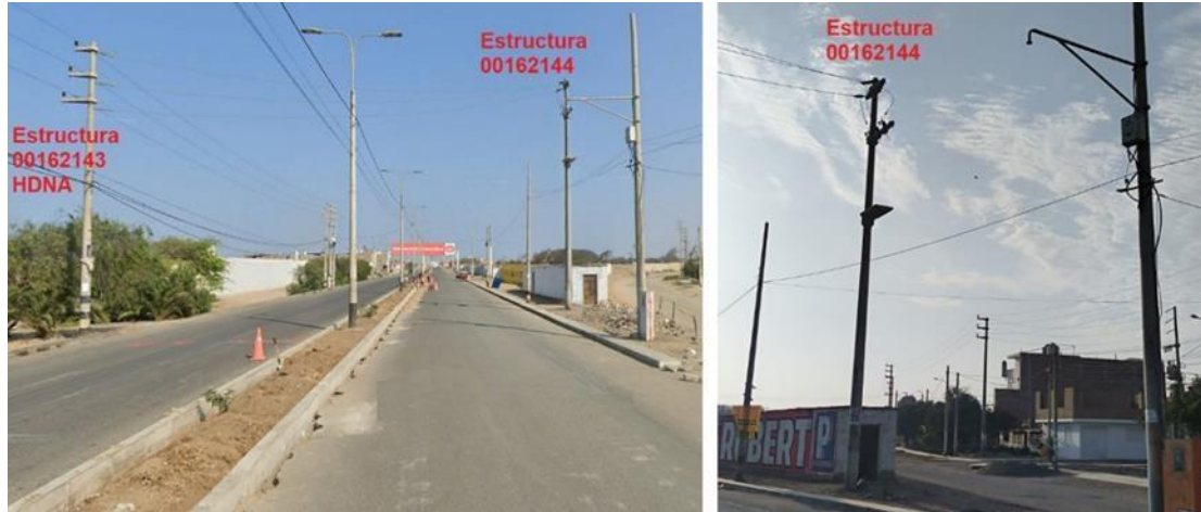
Figura 05: Estructuras 00162144 de MT de Terceros y estructura 00162143 de MT de Hidrandina.
