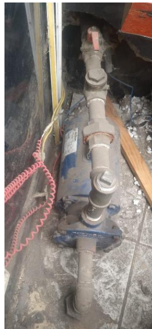
Imágenes 17 y 18: electrobomba de impulsión existente
