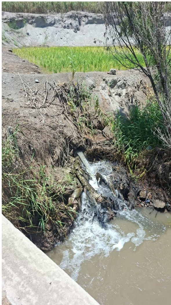
Foto 03. Presencia de malezas en zona de descarga de aguas residuales (se le debe hacer limpieza)
