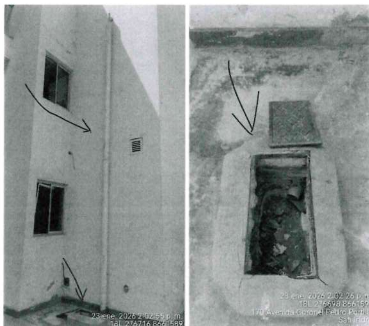
Foto N°3 – cajas de registro a cambiar
