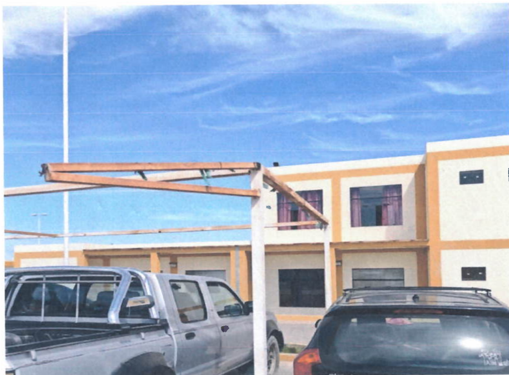
Estructuras a ser removidas por el daño que sufrió
