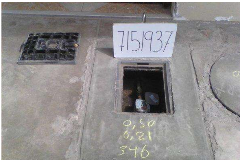
FOTO 01: CONEXIÓN DE AGUA
