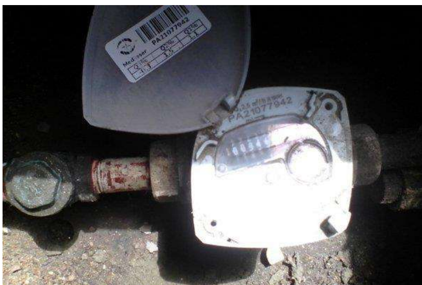
FOTO 03: TOMA INTERNA DE CONEXIÓN AGUA POTABLE
