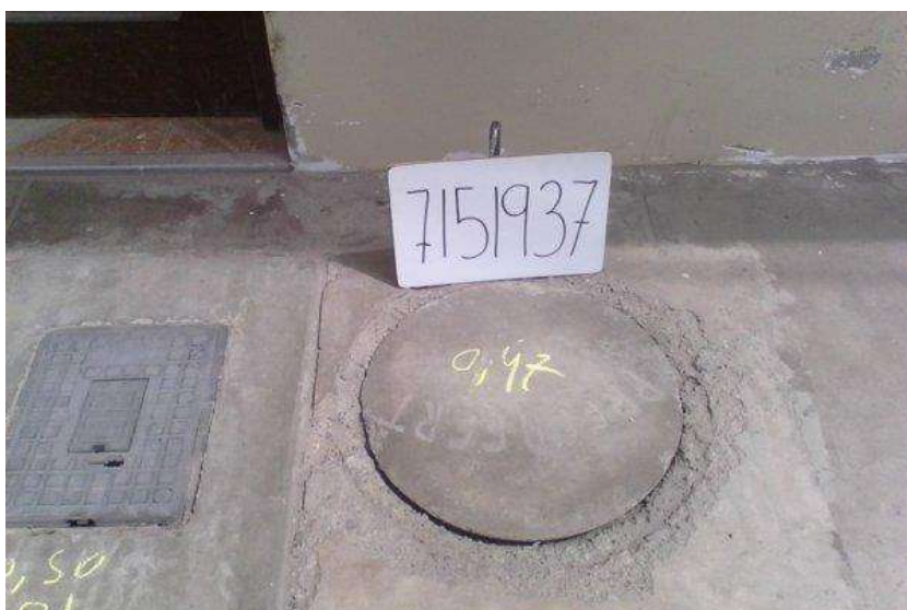
FOTO 02: CONEXIÓN DE ALCANTARILLADO
