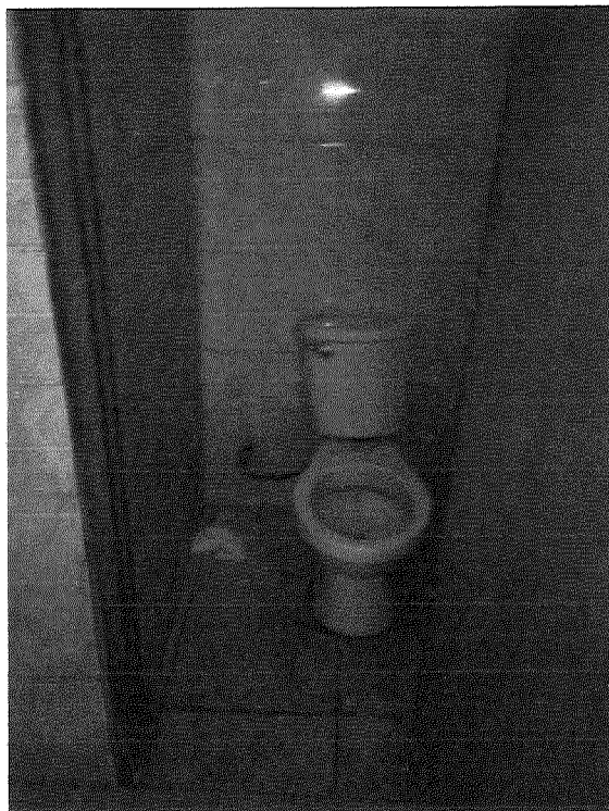
INODORO SS.HH. DE VARONES
