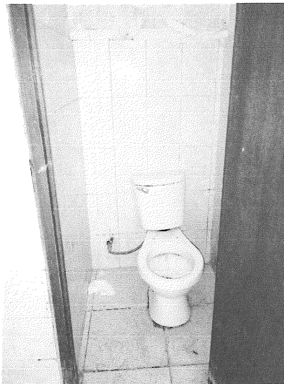
INODORO SS.HH. DE VARONES
