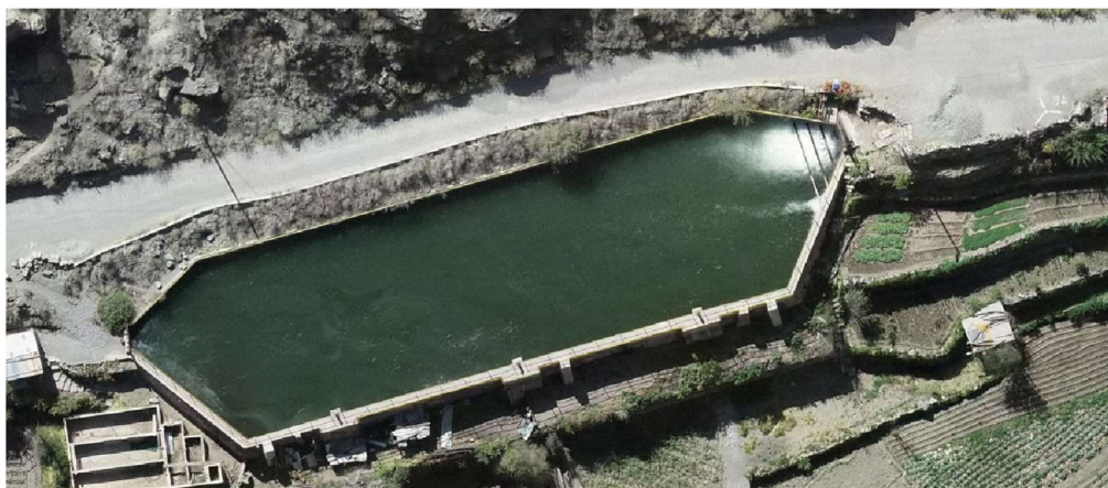
Imagen N° 1: Vista en planta del desarenador el cual tiene una vida útil de más de 50 años atravesó sismos, presencia de filtraciones entre otros.
