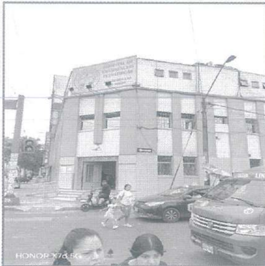
IMAGEN N° 1: El panel publicitario entre la Av. Grau y Jr. Cangallo, se encuentra deteriorado por su tiempo a la exposición y material no apto
