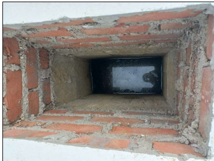
Vista del estancamiento del agua residual en las cajas de registro del sistema de desagüe
