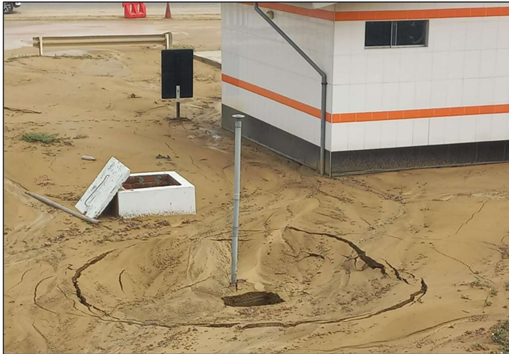
Vista del posible colapso del biodigestor
