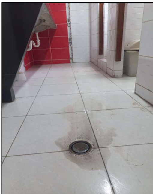
Rebalse de aguas residuales por el sumidero del baño de hombres.
