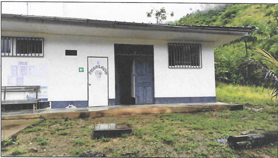
PUESTO DE SALUD SHUNTE – FALTA DE PISO Y ALARGAR TECHO.
