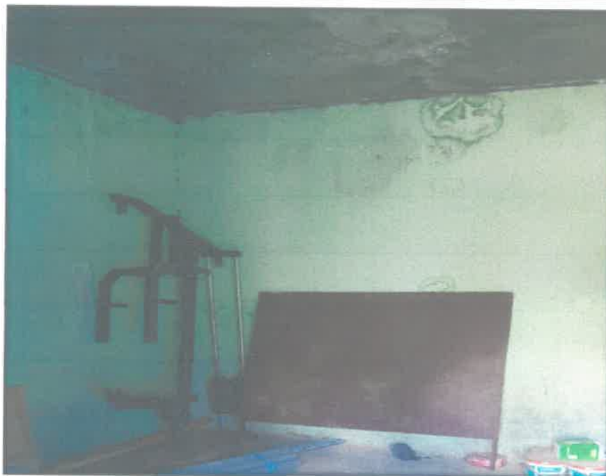
Imagen 06. Muros y techo interior que requiere pintado.
