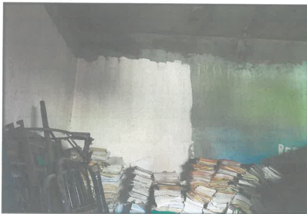
Imagen 05 Muros interiores que requieren pintado.
