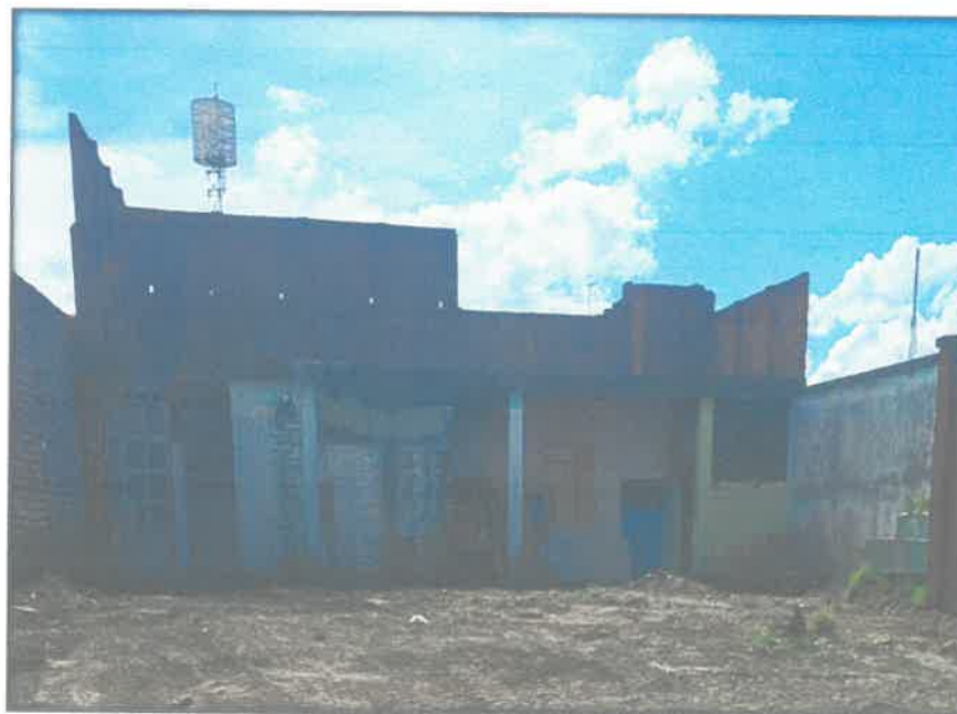
Imagen 07. Vista de muros exteriores que requieren pintura
